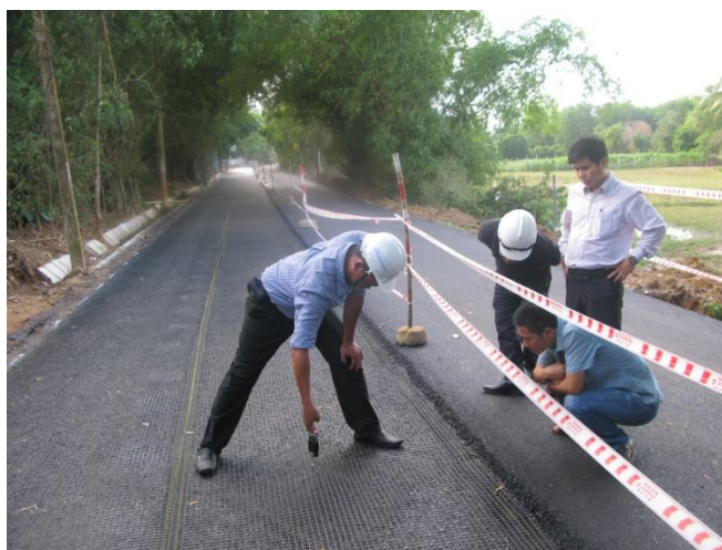
Hình 6. Kiểm tra độ dính bám của lớp lưới địa cốt sợi thủy tinh Glasgird với bề mặt lòng đường
