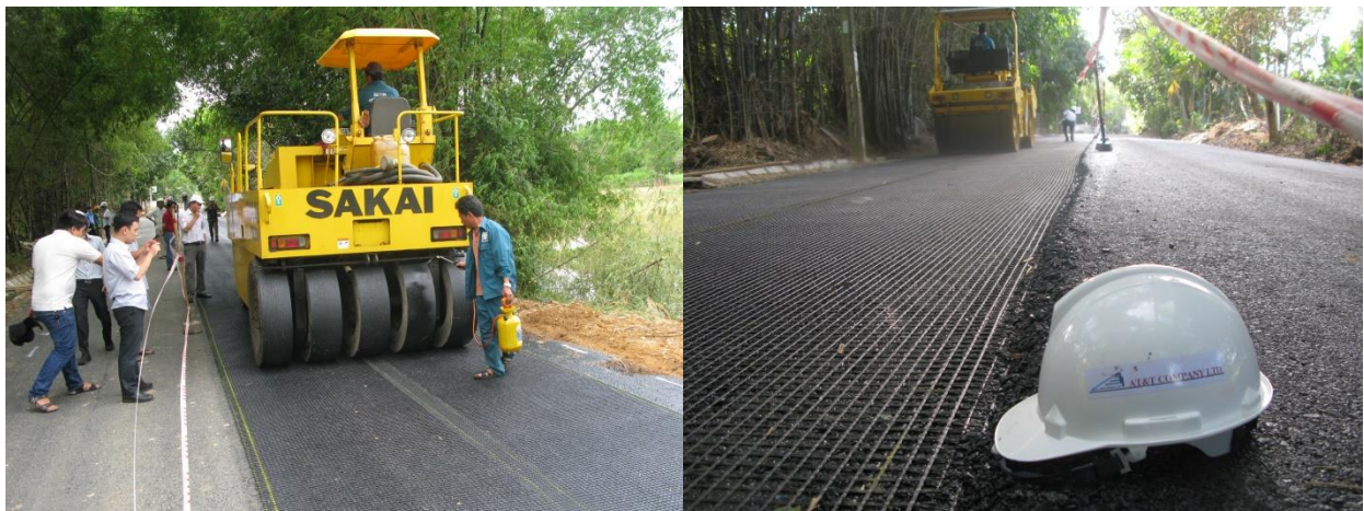
Hình 5. Công tác lu lèn lớp lưới địa cốt sợi thủy tinh Glasgird
