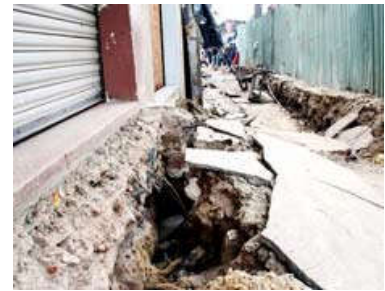
Hình 5.3. Sụt lún công trình
