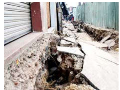
Hình 5.3. Sụt lún công trình
